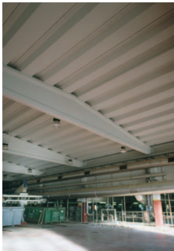
Depuratore - Nosedo (Milano)
